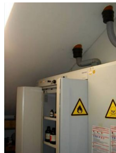
Vorbildlich: Gefahrstoffe in einem Gefahrstoffschrank
