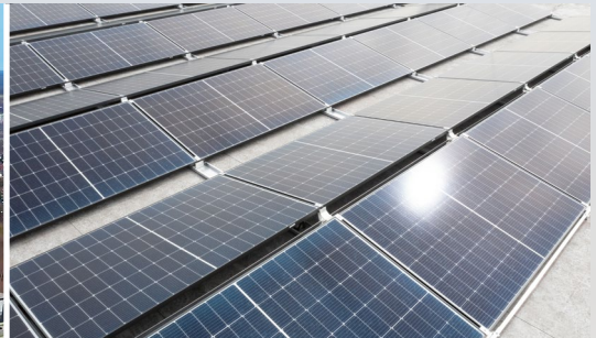
Fotovoltaikanlage im SEGRO Logistics Park Oberhausen
